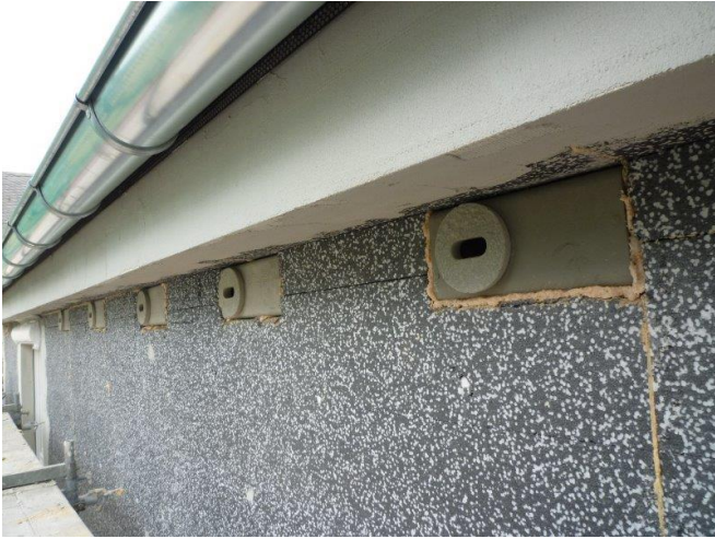
Einzelnistkasten in Isolierung integriert
